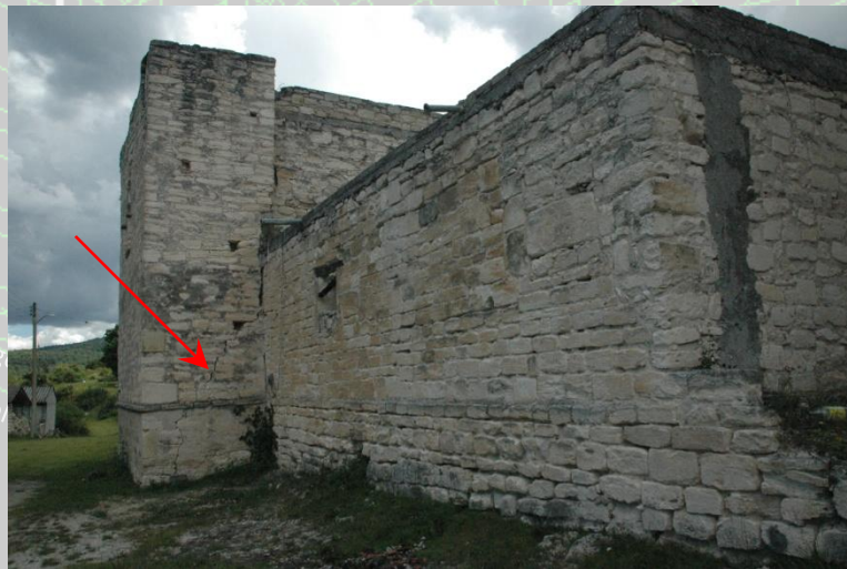
Desprendimiento muro testero
