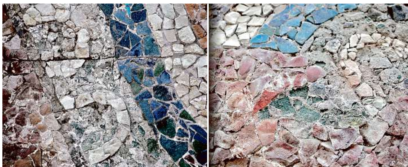
Los murales del Centro SCOP presentan desprendimientos, humedad, pérdida de pigmento y suciedad, entre otras afectaciones.
