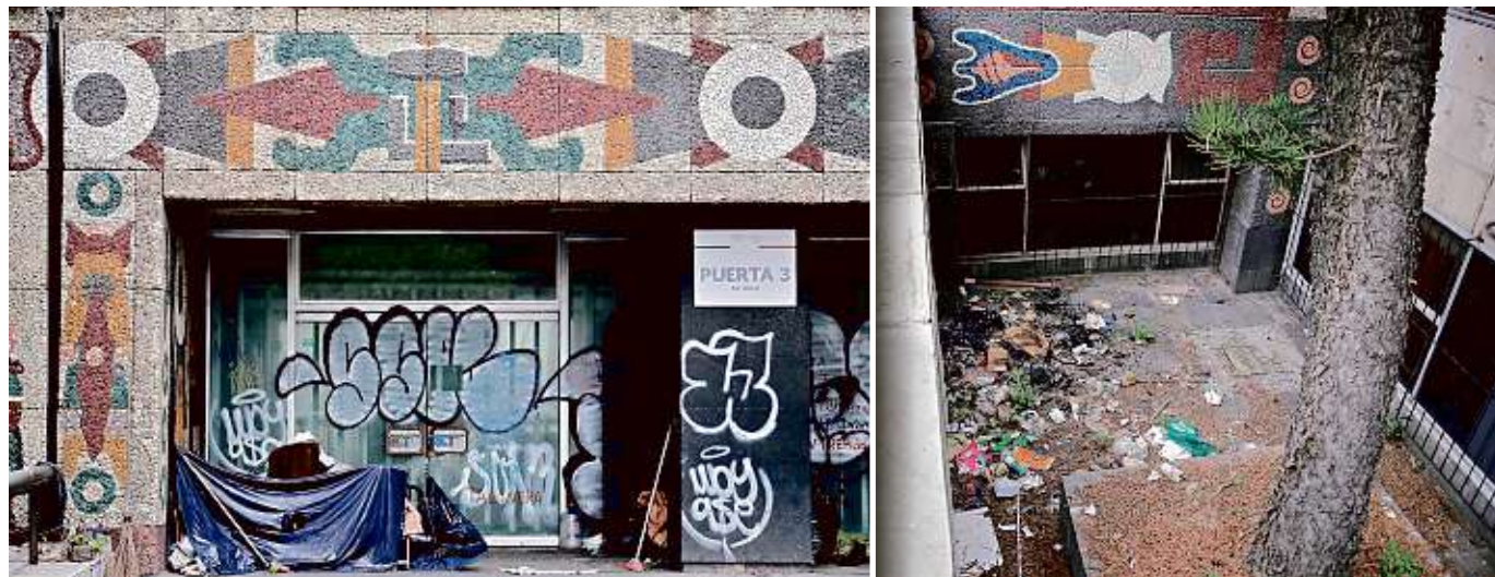
El vandalismo del conjunto comienza a reflejarse en muros y entradas que han sido grafiteadas, y en la acumulación de basura.
